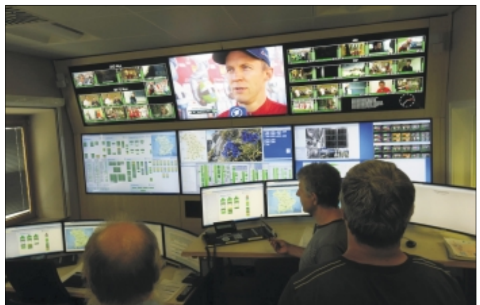
Überwachungsraum beim Sender Wendelstein. Foto: Bernhard Fischer.
