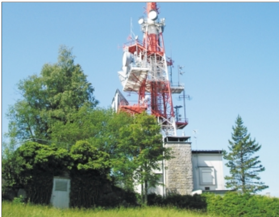
Die Pfänder-Sendeanlage in kompletter Ansicht. Der interne Name der Anlage lautet „Bregenz 1“. Foto: Matthias Hornsteiner.
