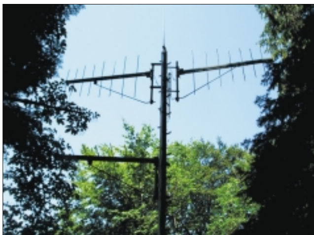
Mittlerweile zieren drei Log-Per-Antennen den grünen Mast. Über die beiden vertikalen Antennen werden Kronehit (91,5 MHz) und Radio OE24 (98,6 MHz) abgestrahlt, über die darunterliegende horizontale Antenne läuft Proton auf 92,7 MHz. Foto: Matthias Hornsteiner.
