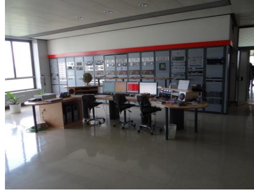
Bild 27: Schaltraum im KW-Zentrum Moosbrunn (Foto: Christian Meyer)
