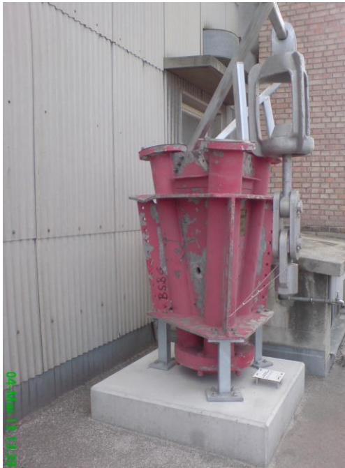
Bild 10: Nordmast MW-Sender Wien Bisamberg.
